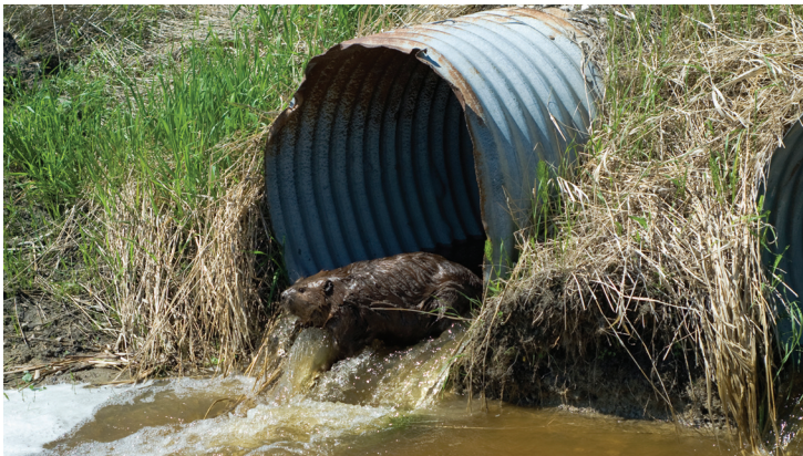
Les ponceaux routiers sont souvent ciblés par le castor pour la construction d'un barrage.
